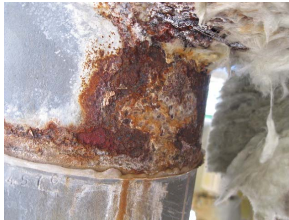
CORROSIONE DA CONDENSA ACIDA ESTERNA
