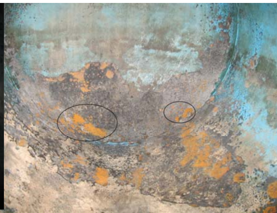
CORROSIONE DA DEPOSITO
